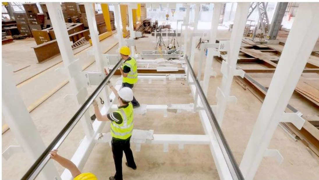
在內地工場橫向安裝升降機的主要部件，例如導軌、對重、機廂等。（TK Elevator影片擷圖）
